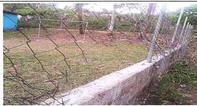
Foto 6. Se observa el deterioro de la malla y los postes.
