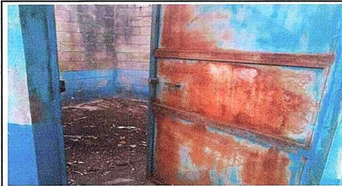
Foto 3. Módulo 1 Se observa derioro de las puertas.
