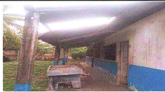
Foto 4. Módulo 2 Se observa el deterioro de las laminas.
