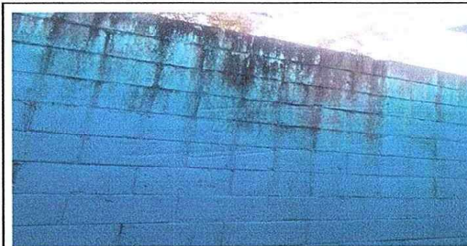
Foto 5. Se observa deterioro de pinturas del interior y exterior.
